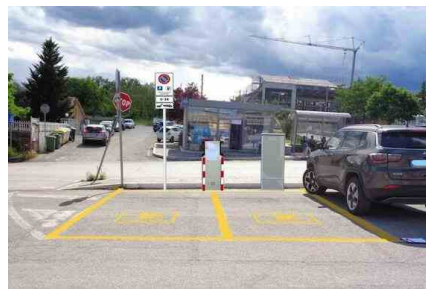
Teramo, nuove colonnine per la ricarica delle auto elettriche: ecco dove 26 febbraio 2022
